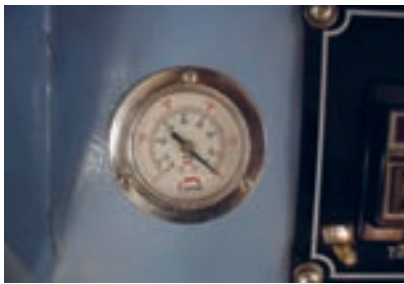
شکل ۴-۱۸- روشن کردن پمپ وکیوم
