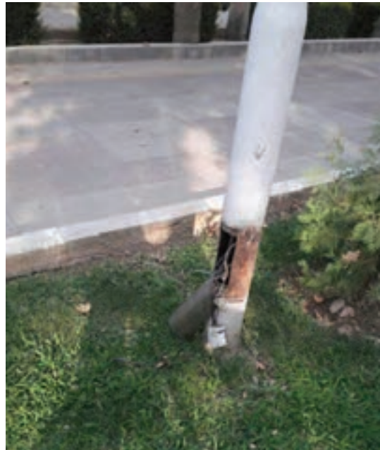
شکل ۲- وجود خرابی در سیستم برق کشی
