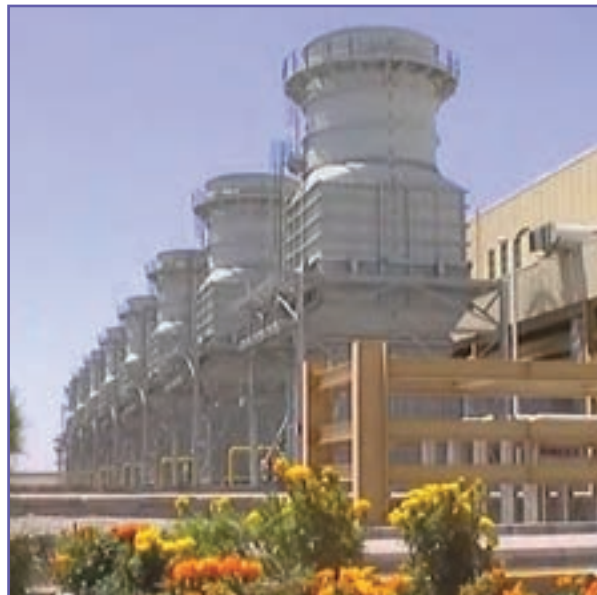
شکل ۶-۶- نیروگاه سیکل ترکیبی کرمان
