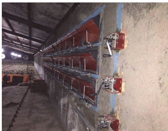
ورود هوا از طریق پنجره‌های خودکار (اینلت)
