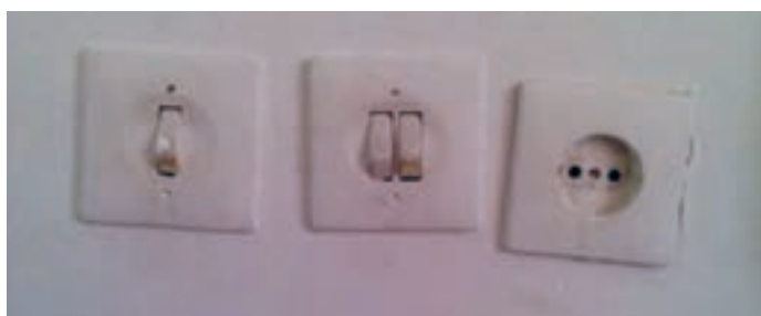
شکل ۱- نصب غلط کلید و پریز
