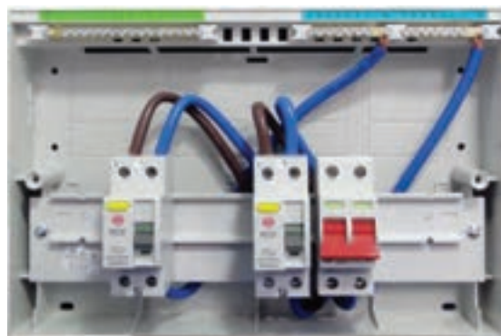
شکل ۴۷- سیم کشی قطعات تابلو
