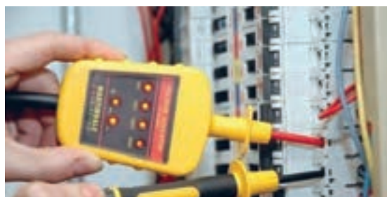
شکل ۵۴- تست تابلو با نشانگر ولتاژ
