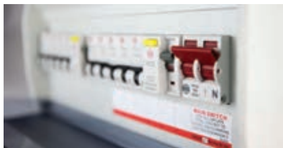
شکل ۷۹- تابلو توزیع برق واحد مسکونی
