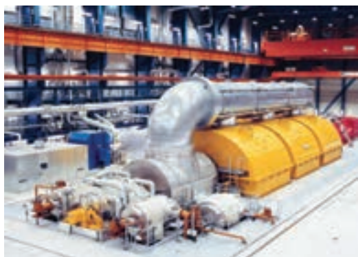
شکل ۲- ژنراتور سه فاز در نیروگاه
