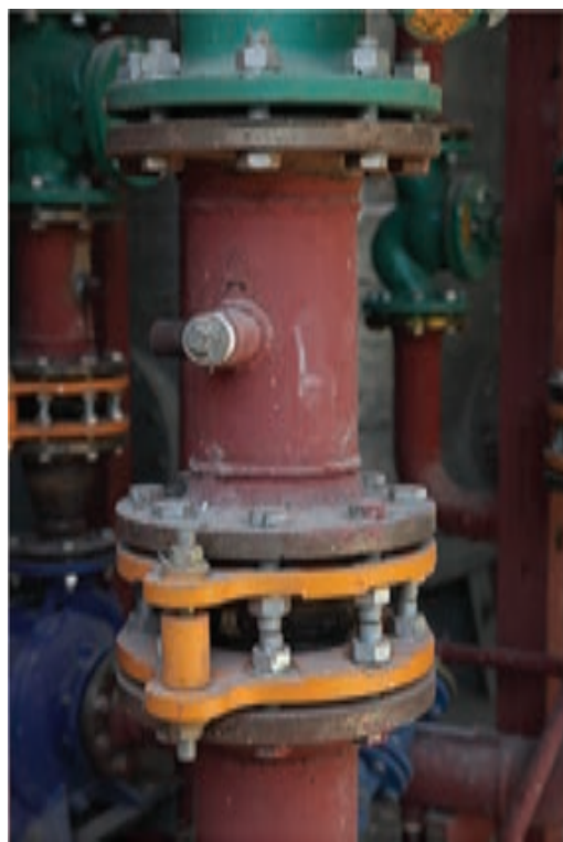
شکل ۲۰- ارتعاش گیر روی پمپ
