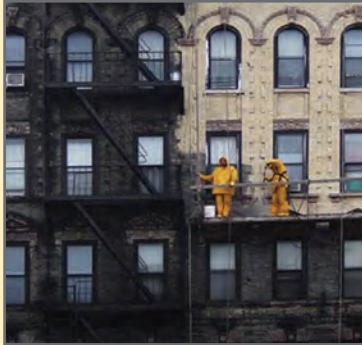
دوده زدایی بر روی نمای ساختمان
