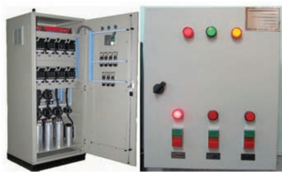
شکل ۴- تابلو برق ایستاده
