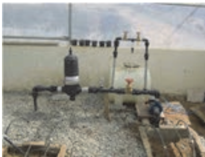
نمونه‌ای از سیستم آبیاری گلخانه
