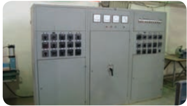
شکل ۸۳-۵: تابلوی اصلی سه فاز برق کارگاه
