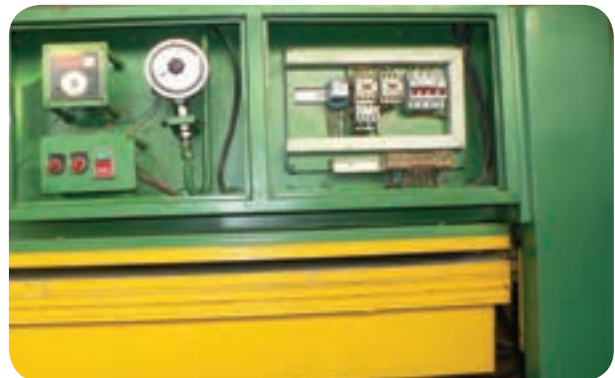
شکل ۸۴-۵: تابلوی فرعی برق نصب شده روی پرس
