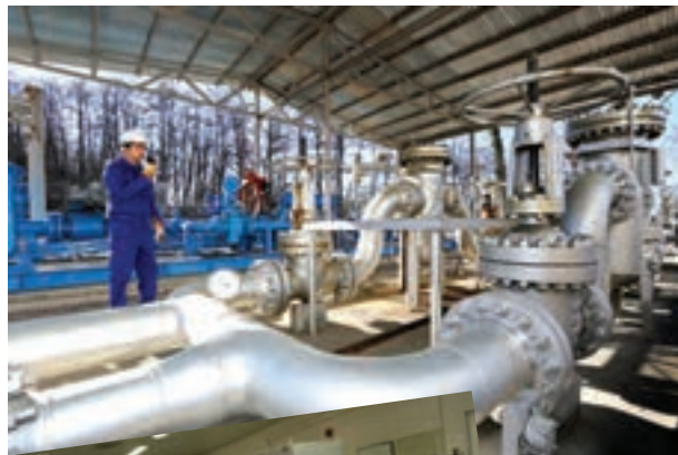
منطقه شمال - ایستگاه فشارشکن لاجیم
