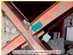
ضعیف بودن جوش و عدم اتصال مناسب
