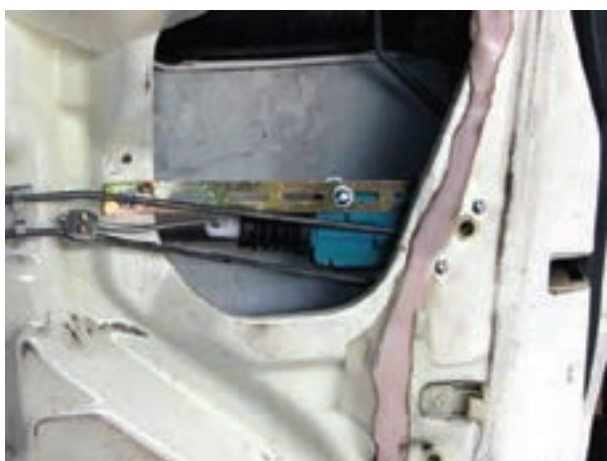
شکل ۲-۳۷- نحوه‌ی اتصال عملگر الکتریکی
