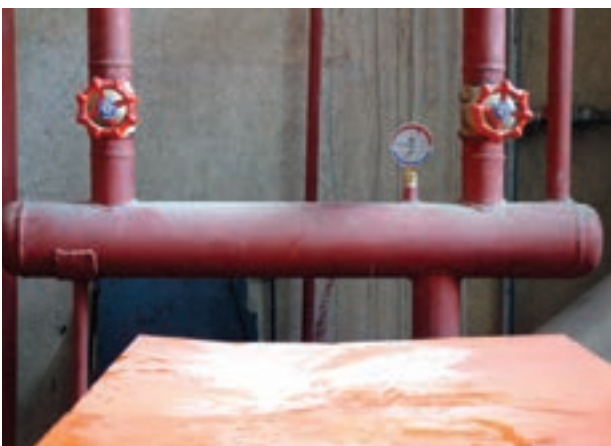
شکل ۳۲-۵- استفاده از اتصال جوشی در حرارت مرکزی
