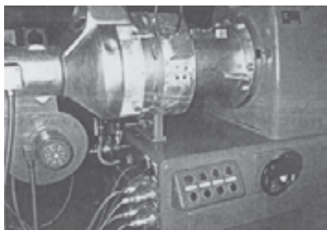
شکل ۴-۲۵- اتصال لوله خرطومی به موتور الکتریکی
