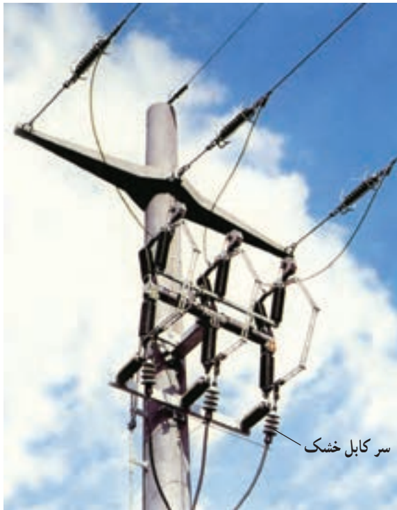
شکل ۶-۶- سر کابل خشک حرارتی هوایی
