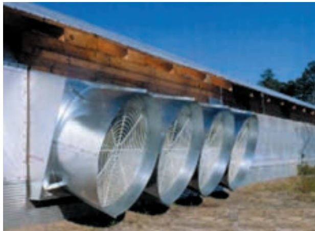
نمای هواکشها از بیرون جایگاه
