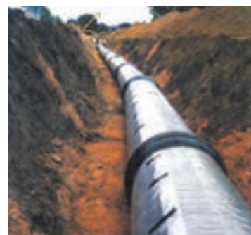
▲ شکل ۲-۲۱ لوله‌کشی انتقال آب شهری
