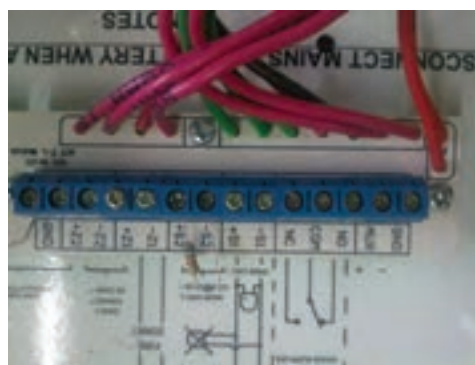
شکل ۱-۳۱ ترمینال های اتصال
