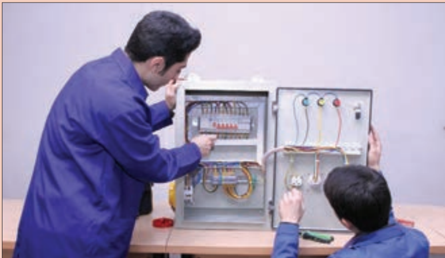
شکل ۳۰- قطعات الکتریکی و غیر الکتریکی تابلو برق
