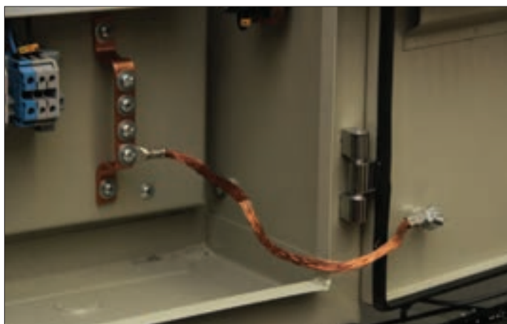
شکل ۹۲- صفحه نصب در داخل تابلو
