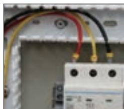
نصب غلط شماره سیم
