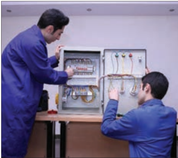
شکل ۲- تابلو برق فشار ضعیف
