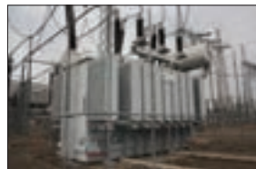
شکل ۱- تصویر ترانسفورماتور قدرت
