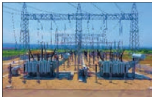
شکل ۳- پست تقویت ولتاژ
