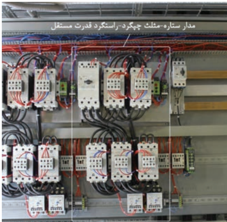
شکل ۴۳- یک نمونه دیگر از تابلو قدرت مستقل
