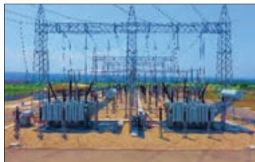
شکل ۳- پست تقویت ولتاژ
