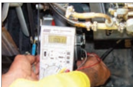
شکل ۳۰- آزمایش اجزای داخلی آلترناتور
