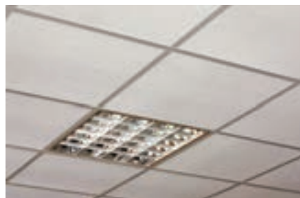
شکل ۳-۴- سقف کاذب مشبک
