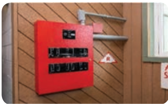
شکل ۳-۴۹- تصویر تابلو کنترل
