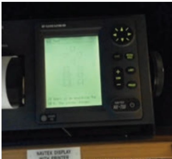
شکل ۴۳- آزمایش کلیدهای دستگاه NAVTEX
