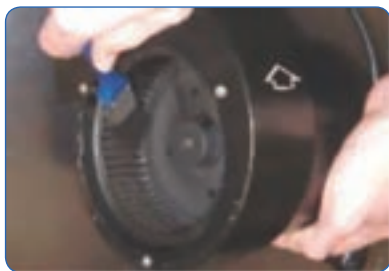
تمیزکردن فن مشعل از گردوغبار
