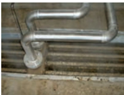
شکل ۶۱- کویل‌های حرارتی برای گرم کردن هوای کوره
