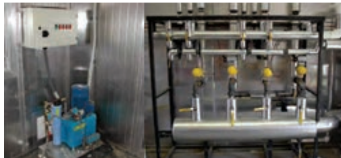
شکل ۶۰- شیرهای کنترل بخارزنی
