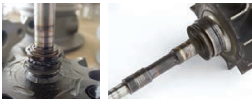
شکل ۸۵- خرابی یاتاقان‌ها و محور توربوشارژر
